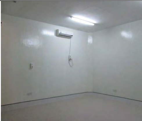
写真-3： 新手術室 新手術・画像診断棟2階に位置する。空調設備は壁掛けエアコンのみで、手術室の清浄度の確保ができない。
