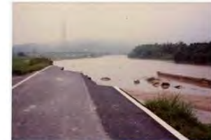
写真 2.2-5 大津市上田上の道路被害
