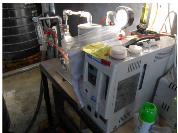
水素酸化脱窒装置（硝酸態窒素除去） (撮影場所：Jwagal/撮影日：2016年11月21日)
