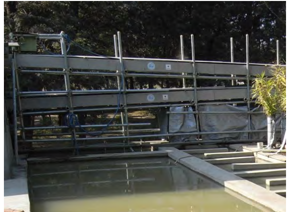
スポンジ傾斜水処理装置（鉄、懸濁物質除去） (撮影場所：Jwagal/撮影日：2016年11月21日)
