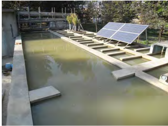
水処理システムの研究開発が行われている 給水施設 (撮影場所：Jwagal/撮影日：2016年11月21日)
