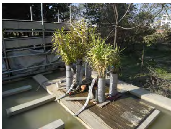
人口湿地装置（窒素除去） (撮影場所：Jwagal/撮影日：2016年11月21日)
