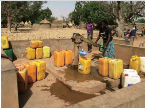
中央プラトー州 Sourgoubila コミューン Guela 村 我が国の無償資金協力で 1999 年建設、ブルキ ナ製の DIAPA ポンプは建設時のもの、揚水管 1 本 (3m) を修理時に抜いているが、状態よく稼 働している。
