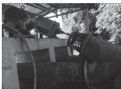
取水ポンプの劣化
