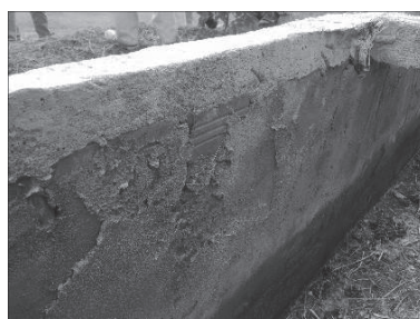
水路の施工不良
