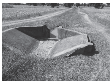
水路トランジションの破損
