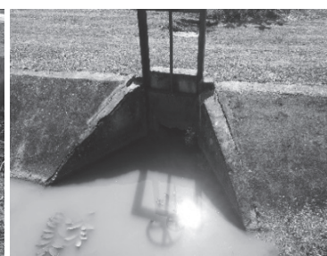
分水ゲートの破損
