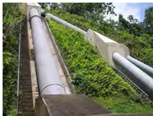
写真 5-15 水圧鉄管（発電所建屋より）
