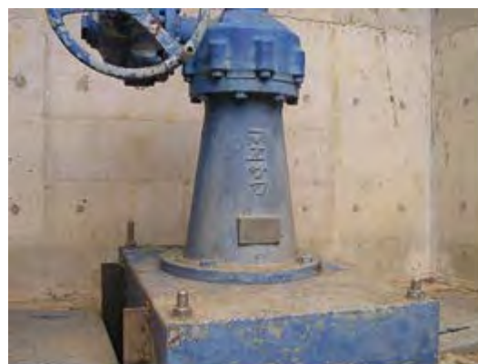
写真 5-9 排砂門巻上部
