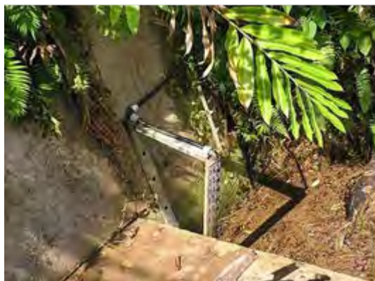
写真 5-3 取水堰脇に設置された量水票
