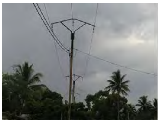
写真 5-33 5.5 kV 配電線 (低圧配電線の共架区間)
