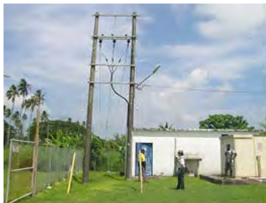
写真 5-32 20 KV/5.5kV ルーガンビル変電所
