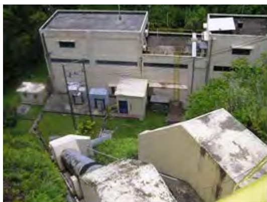
写真 5-14 水圧鉄管（水槽より）
