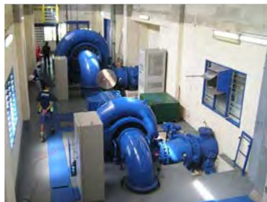
写真 5-17 水力発電機器
