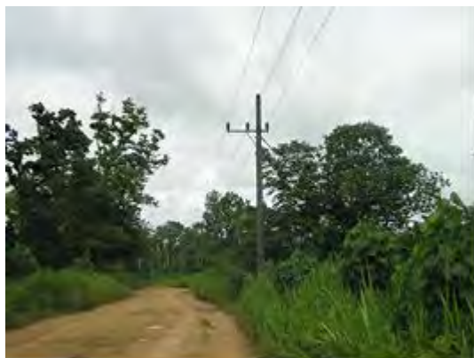
写真 5-31 20 kV 送電線(サラカタ水力～ルーガンビル)
