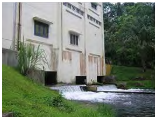
写真 5-20 発電所放水口
