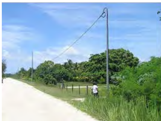
写真 5-35 新規延長された低圧配電線 (Million dollar 付近)
