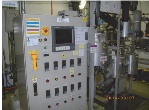
ガス精製プラント (JX社による設計)
