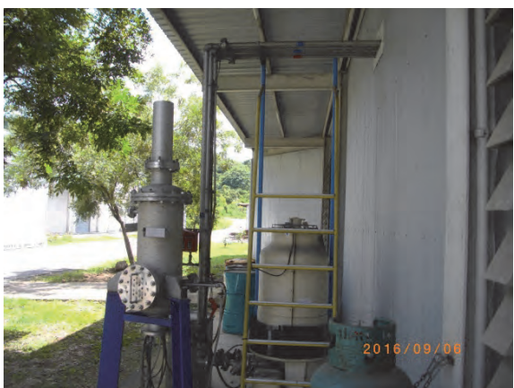
ガス化装置（本事業で屋根等を整備し新機材 を設置する予定）
