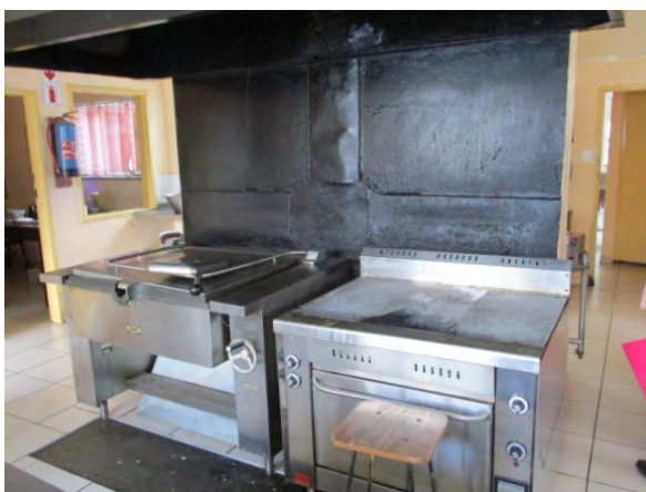
写真 17. 類似校 Mhlatane 中等学校 厨房 寄宿舎が併設され、厨房は電気式の近代的な設備が整備されている。
