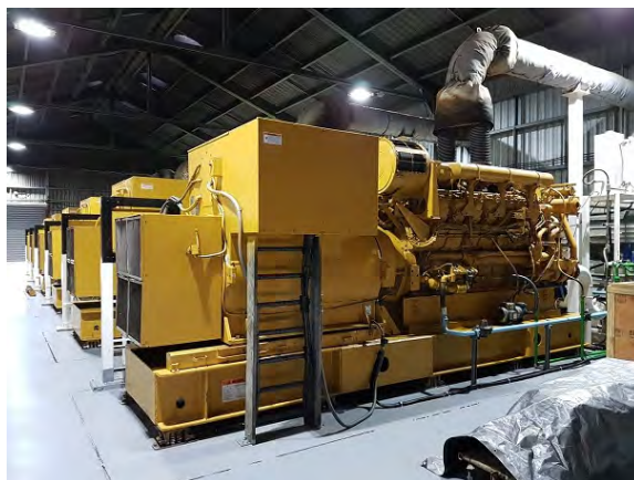
CAT 製ディーゼル発電機 (No. 1 建屋内) スケジュールに従って定期的に点検が行われている。
