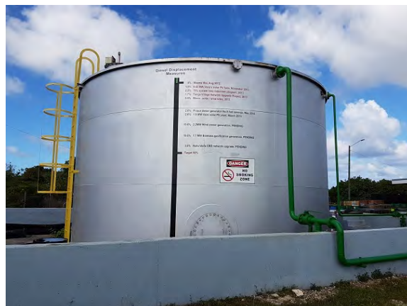
オイルタンク（ポア発電所） トンガタブ島内の軽油備蓄基地から、ローリーで陸送される。燃料は全て輸入に依存しており、燃料消費量の削減が課題となっている。
