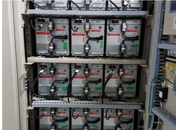
リチウムイオンキャパシタ 日本の無償資金協力で整備された蓄電設備である。太陽光発電の短周期変動補償に対応している。
