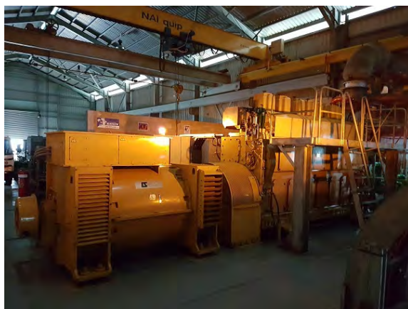
MAK 製ディーゼル発電機 (No. 2 建屋内) 調査期間中に冷却水の循環に問題があり緊急停止したが、40 分ほどで復帰した。
