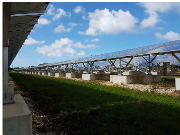
太陽光発電所 （Maama Mai 発電所：NZ 支援、1.3MW） ポア発電所内にある太陽光発電所である。日本の無償資金協力により、蓄電設備が整備された。
