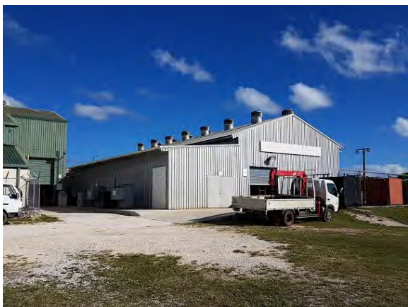
ボア発電所 (No. 1 建屋 : ディーゼル発電) CAT 製発電機 6 台が格納されている。発電機が適切に管理されており、排出ガスが非常に澄んでいる。
