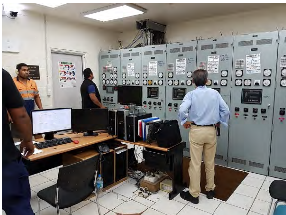
ポプア発電所内の制御室（CAT 製発電機） CAT 製発電機の制御盤に加え、SCADA により MAK 製発電機、太陽光発電施設が一元的に管理されている。
