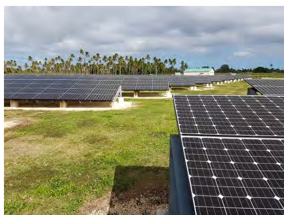
太陽光発電所 （Mata 'o e La'a 発電所：日本支援、1.0MW） バイニ地区にある、日本の無償資金協力により整備された施設である。
