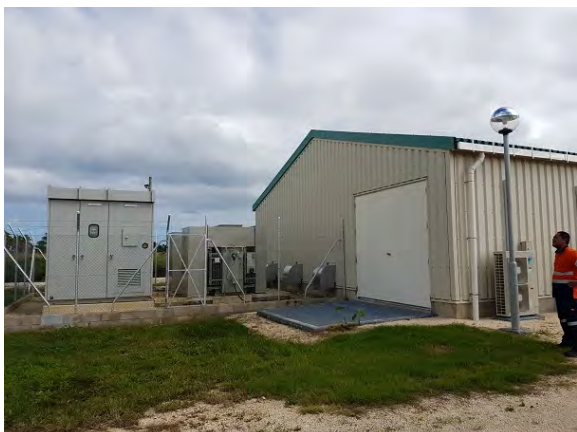
蓄電設備棟 (Mata 'o e La'a 発電所) バイニ地区の太陽光発電施設に日本の無償資金協力により整備された設備である。蓄電設備、変圧器を介して系統に接続されている。
