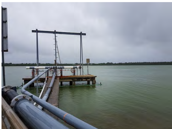
冷却水の取水口（ポプア発電所） 定期的に清掃が行われているが、清掃時にバルブを閉め、終了後のバルブの開け忘れにより、全ディーゼル発電機が停止した。
