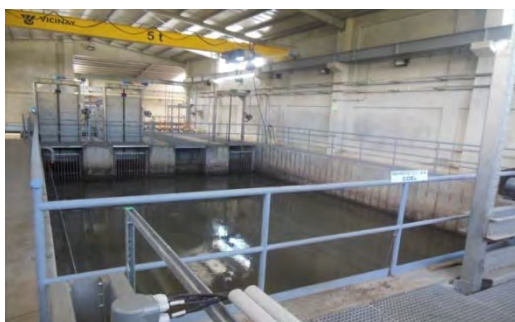
Cámara de carga
