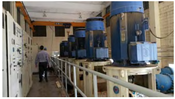
Estacion de Bombeo Agua Cruda
