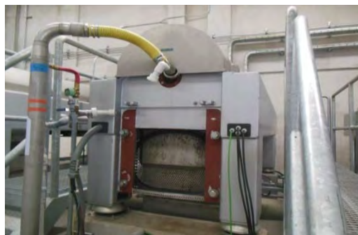
Equipo de deshidratación de lodos en la PTAR Los Tajos
