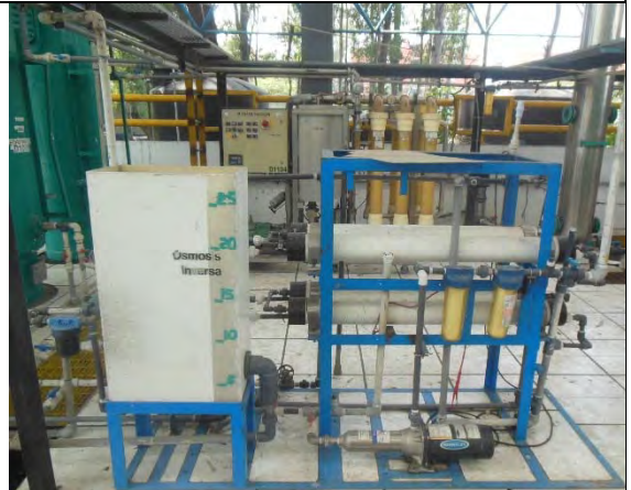
Sistema de Ultrafiltración (Piloto)
