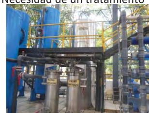
Instalación piloto para tratamiento avanzado ya existente
