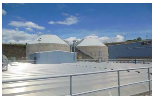
Cuencas cubiertas de sedimentación y digestores de lodos(fondo)
