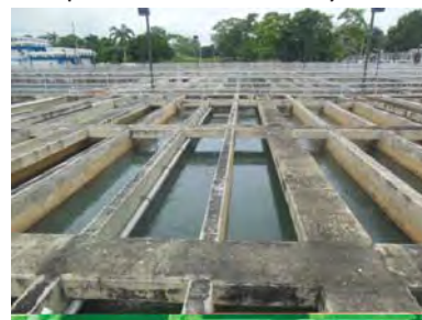
Planta potabilizadora de Chilibre
