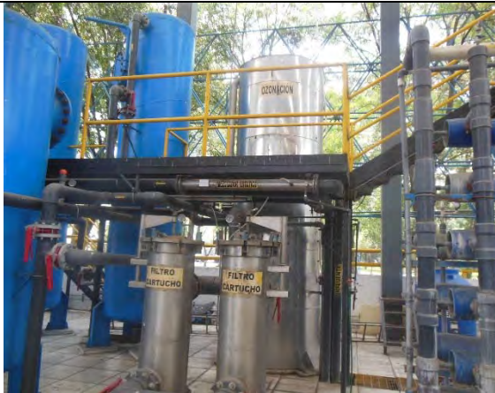
Planta Piloto de Osmosis Inversa (azul)
