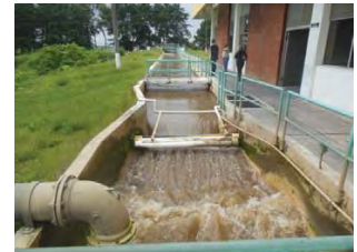
Agua que entra en la planta de tratamiento de Coy
