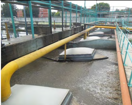
Reactores Biológicos en la PTAR del Cerro de la Estrella
