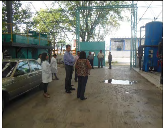
Planta Piloto de Ultrafiltración (verde) en la PTAR del Cerro de la Estrella
