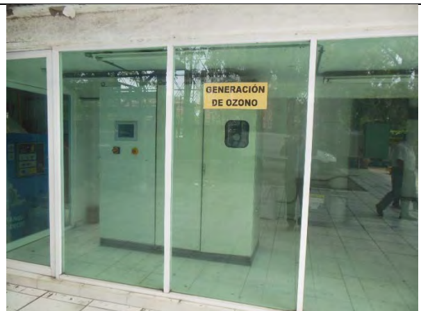
Generadores de Ozono en la Planta Piloto
