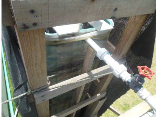
ロス・タホス下水処理場内のDHS試験設備
