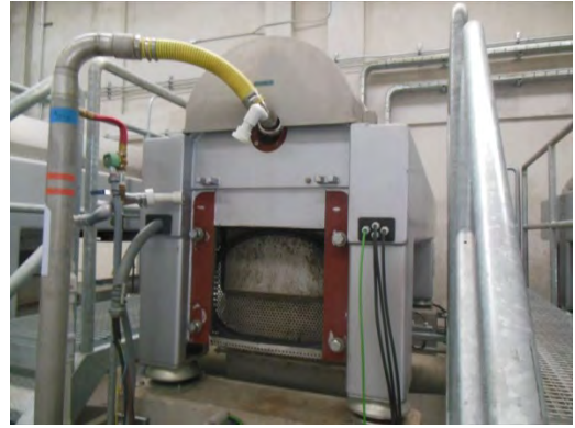
既存汚泥脱水機
