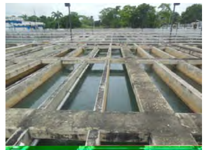
チリブレ浄水場
