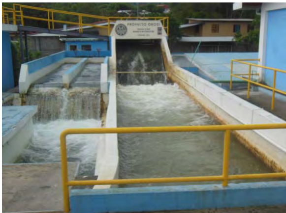
既設トレス・リオス浄水場へのオロシ-Iからの流入水
