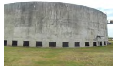
マナグア市下水処理場散水ろ床タンク
