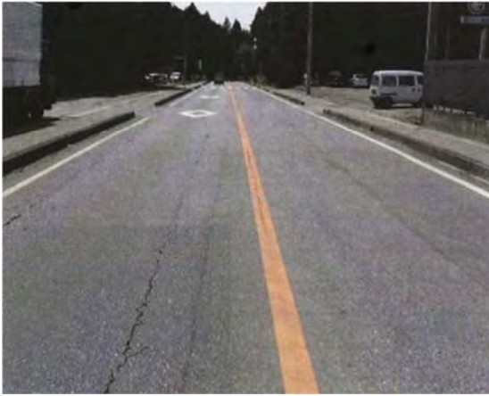
写真-7：わだち割れの例
