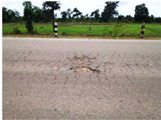
写真-10：路床・路盤の沈下によるひび割れ
