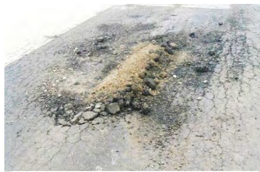
写真 PIの大きな赤土を使ったセメント安定処理の破損事例 出典：JICA 調査
