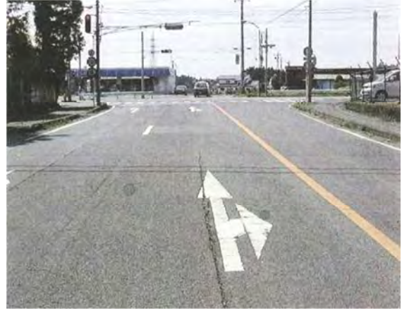
写真-8：施工継目のひび割れの例
