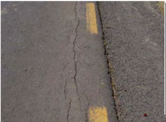
写真 地方部幹線道路 膨張土（ブラックコットンソイル）の影響により、舗装端部に縦クラックが発生したもの。 出典：SAPEM Chapter-6
