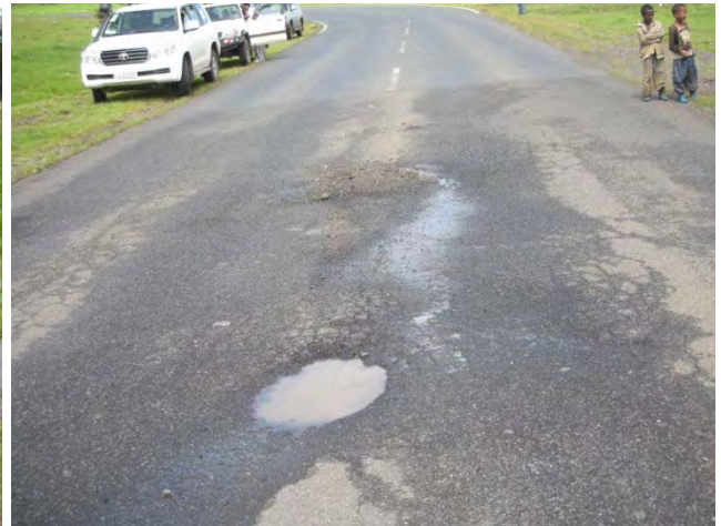
水の滞水による舗装の破損
