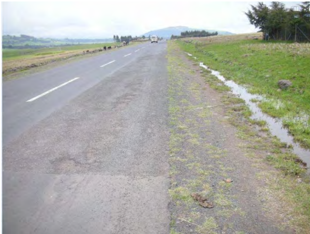
水の滞水による舗装の破損
