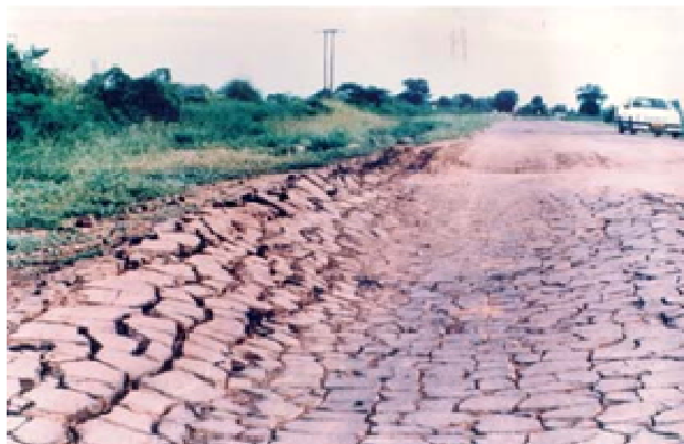
舗装厚不足によるひび割れとわだち
