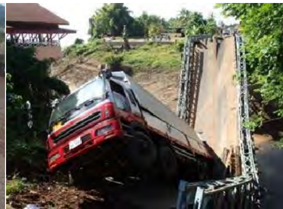
過積載により崩壊した橋梁
