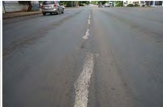
ザンビア：改修後の Livingstone Road（交差点部のわだち掘れ）
