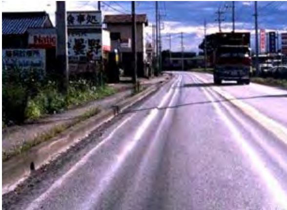
過積載車両によるわだち掘れ
