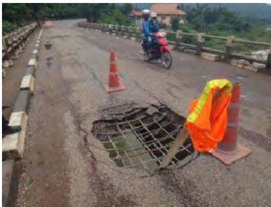
コンクリート床版のポットホール
