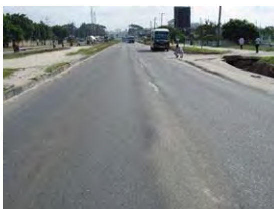
写真 タンザニア国：ほぼ平坦な地形の都市部幹線道路で発生したわだち掘れ。車線表層部が中央側に流動している。
