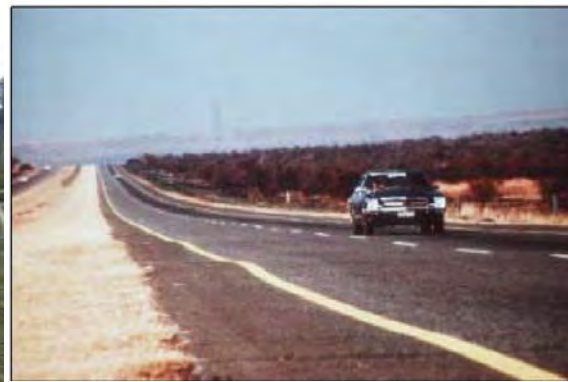
写真 南アフリカの事例（膨張土により盛り上がったカルバート上の道路）
