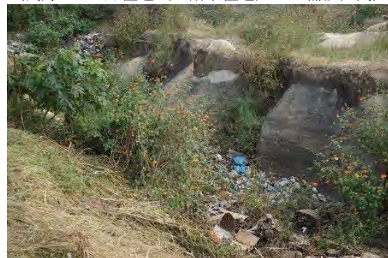
ザンビア：ルサカ市 Tokyo Way （補修原因となった近隣住民による採掘跡）
