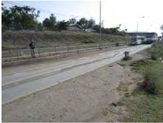
写真 エチオピア国：都市部幹線道路 膨張土（ブラックコットンソイル）の影響により、舗装下部の支持力が低下し、表面にわだち掘れが発生したもの。
