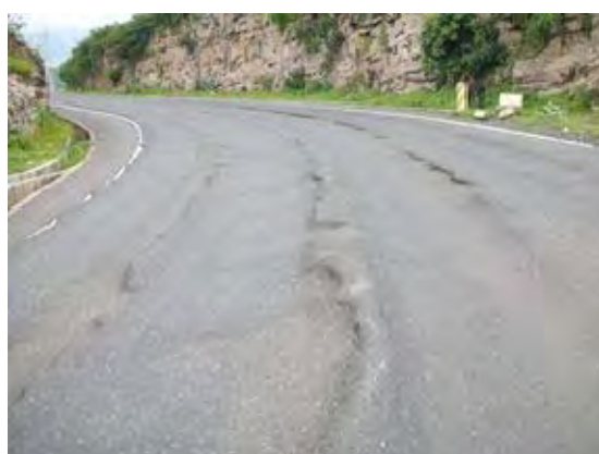
写真 エチオピア国：急峻な山岳部の地方部幹線道路で発生したわだち掘れ。急勾配の曲線区間であり、表層が曲線の内側へ流動している。
