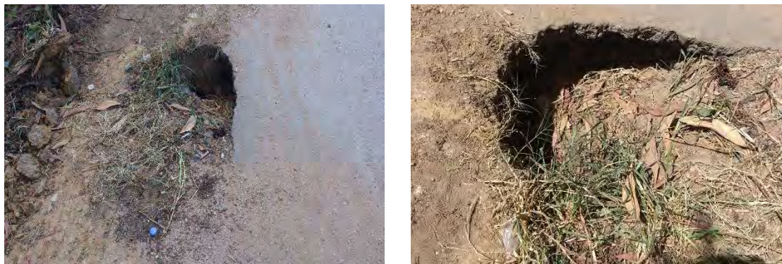
写真 発生したドラゴンホール
