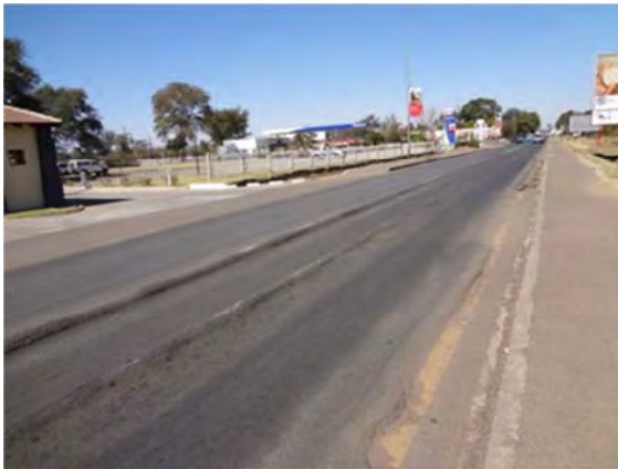
ザンビア：改修前の Livingstone Road（過度のわだち掘れ）
