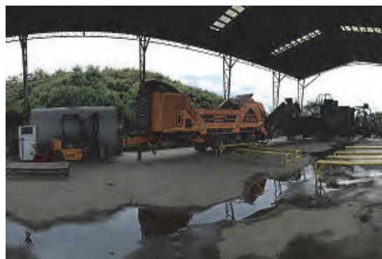
破砕機及び燃料タンク
