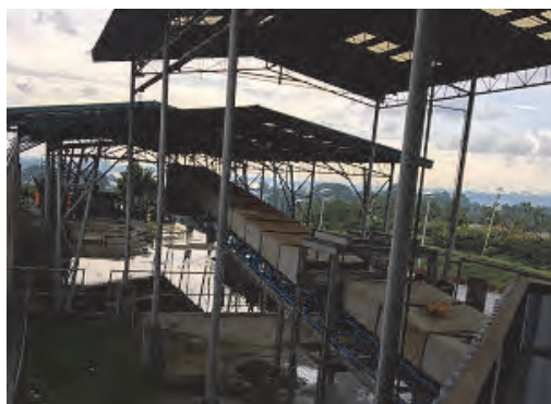
選別ラインから破砕機方向に延びるコンベヤの様子
