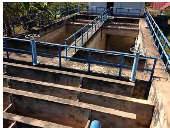
フロック形成池と沈澱池
