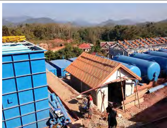
ろ過池 5基（円柱形）と浄水地 11基（真ん中奥のタンク）、左は（Clarifier）
