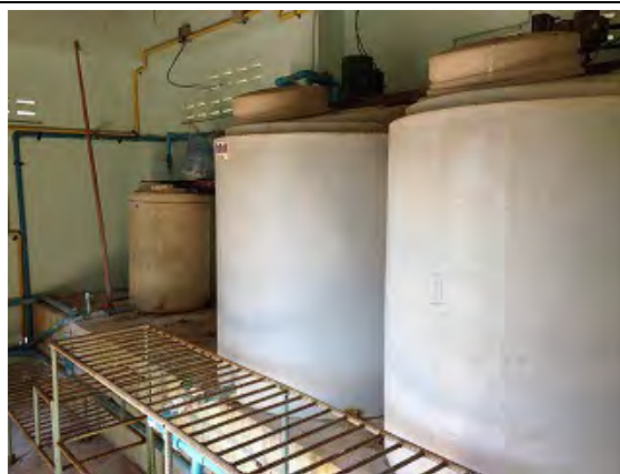
薬品注入設備
