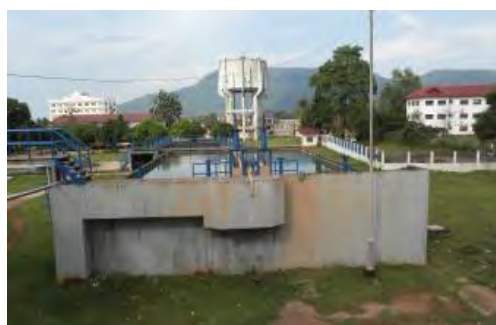
パクセ郡KM2 浄水場 (ADB 支援部分)
