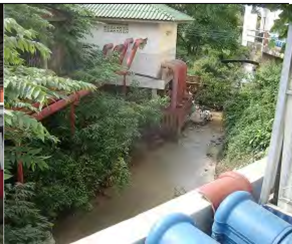
排水路から安定化池へのポンプ設備
