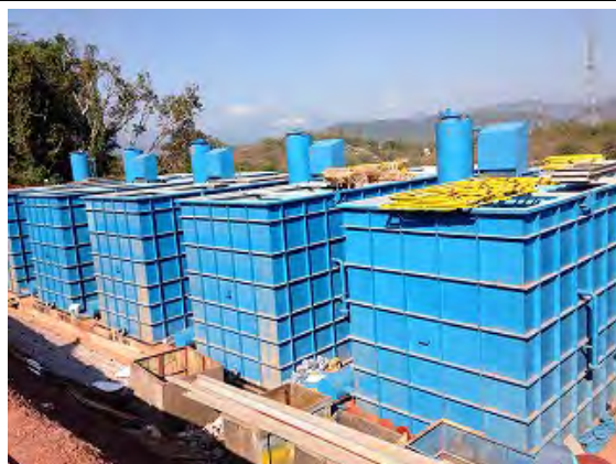
上向流式 Clarifier (6基)
