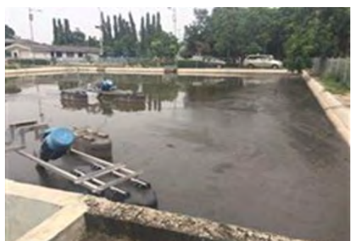
PD Pal Jaya ㊦尿処理設備
