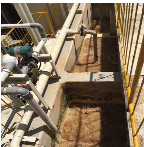
アルシー曝気槽 (Tanjung Priok, Jakarta)
