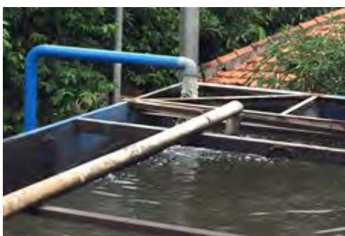
左記住宅向け下水処理設備 (200 m 3 /日)
