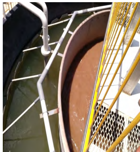
アルシー主要処理タンク (Tanjung Priok, Jakarta)
