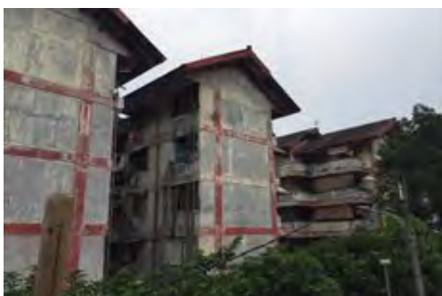
PD Pal Jaya 下水処理設備管理の住宅
