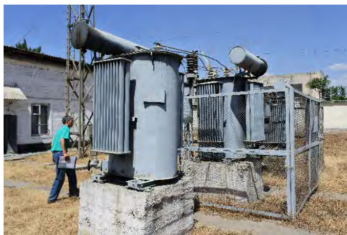
別添図 7-4 消弧リアクトル (プロミシレンナヤ変電所)
