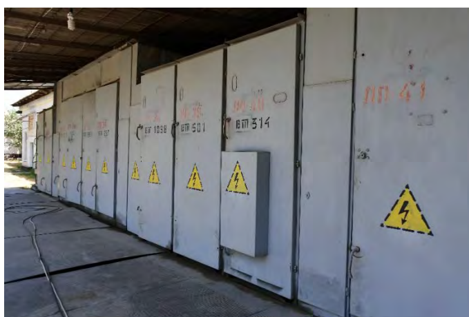
別添図 7-3 プロミシレンナヤ変電所 10kV スイッチギア
