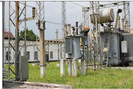
25MVA 変圧器と 10kV 配電盤建屋
