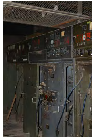
10kV 屋内配電盤
