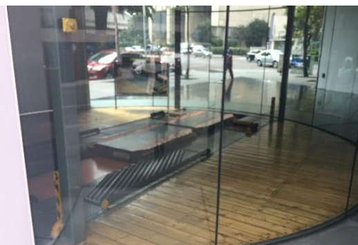
韓国製の地下式円形駐車場
