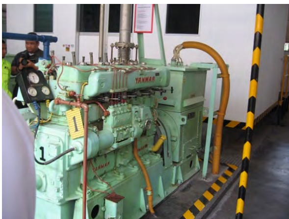
写真 7-3 研修用発電機実機。古いが良く手入れされ、活用されている
