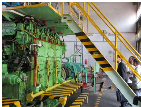
写真 7-2 研修用主機実機。日本の支援で設置されたもの。まだ現役である
