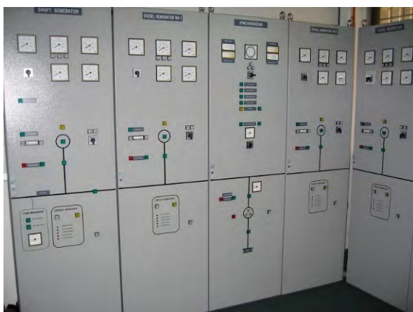
写真 7-5 配電盤の運用を訓練するシミュレーター
