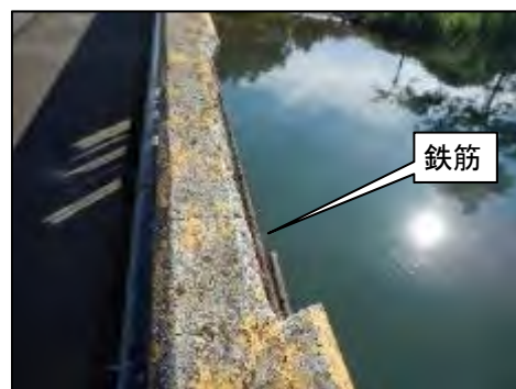
⑯ 鉄筋むき出しの高欄
