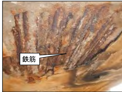
⑩ 腐食の著しい鉄筋
