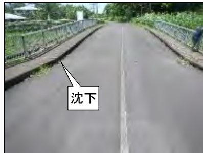
写真 2-2-2 沈下した橋面
