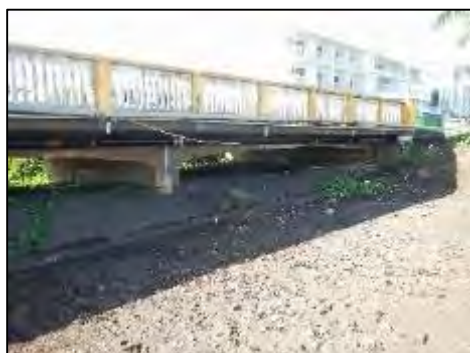
⑦ ヴァイシガノ橋の堆砂状況
