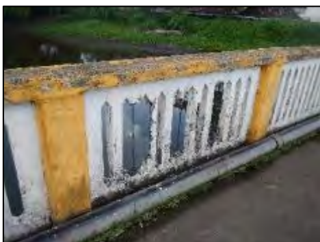
⑮ 損傷した高欄
