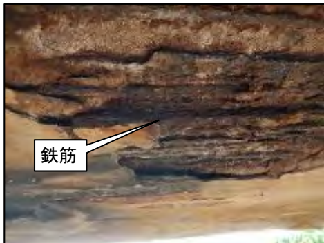
⑬ コンクリートの剥落
