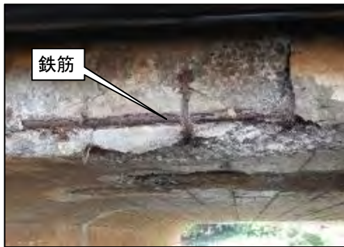
⑪ かぶりの剥れた鉄筋
