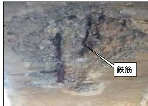
⑭ コンクリートの剥落
