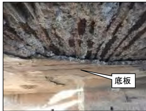
⑫ 剥れたコンクリート底板
