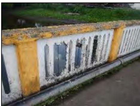
⑮ 損傷した高欄
