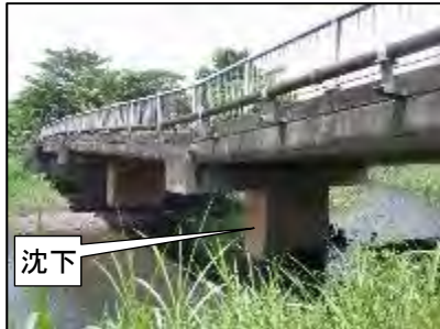
写真 2-2-1 沈下した橋脚
