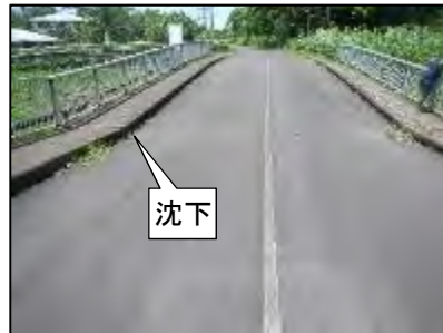
写真 2-2-2 沈下した橋面
