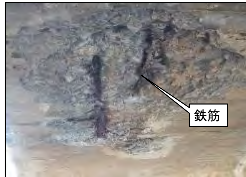
⑭ コンクリートの剥落
