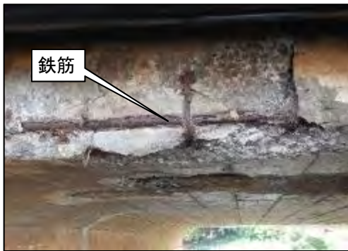
⑪ かぶりの剥れた鉄筋
