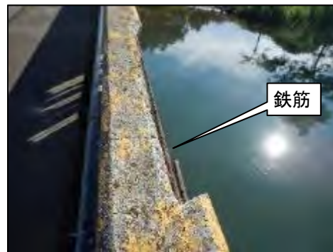
⑯ 鉄筋むき出しの高欄
