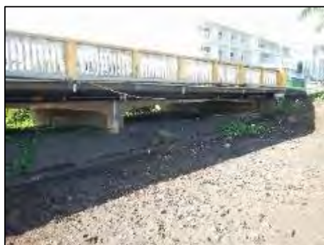
⑦ ヴァイシガノ橋の堆砂状況
