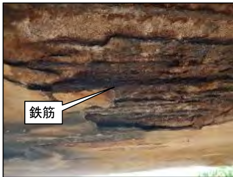
⑬ コンクリートの剥落
