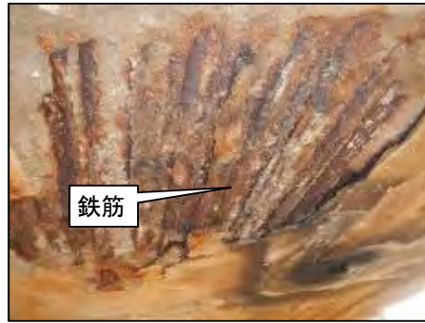
⑩ 腐食の著しい鉄筋
