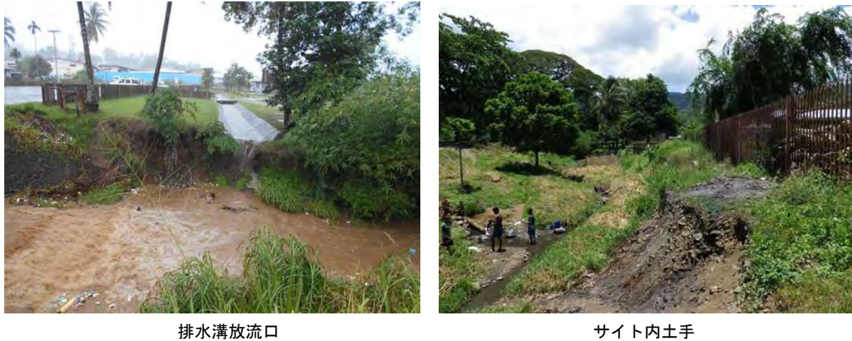
図 3-4 小河川天然土手の浸食状況
