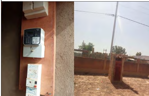
15 カディオゴ県ワガドゥグ第10行政区 Bendogo 小学校：電力の引き込みがある。2つの小学校では別メーターを設置。
