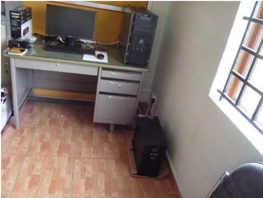
GDMR 庁舎 3 階のサーバールーム内のサーバー（デスク上）と無停電電源装置（床上）
