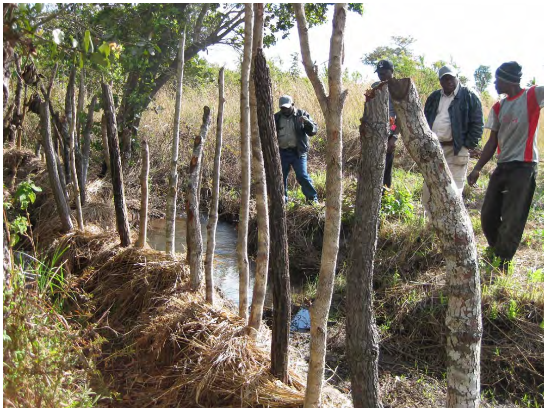
最も簡単なシングルライン堰の例である。北部州 Mbara 郡、Mambwe 村に建設された簡易堰であるが、30 人程の参加によって約半日で建設は終了している。なお、写真右下が水路である。簡易の堰ではあるが 20~50cm 程度の水位の堰上げが可能である。
