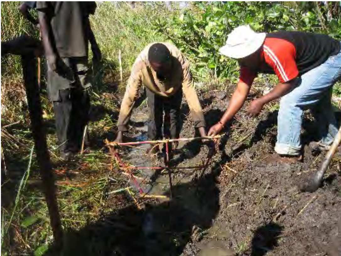
水路の掘削にはテンプレートを使用しているサイトもある。写真は小枝を組み合わせ、底幅 30cm、深さ 40cm、法面勾配 1:0.5 のテンプレートを作り、ポイント毎に掘削断面の確認をしている様子である。
