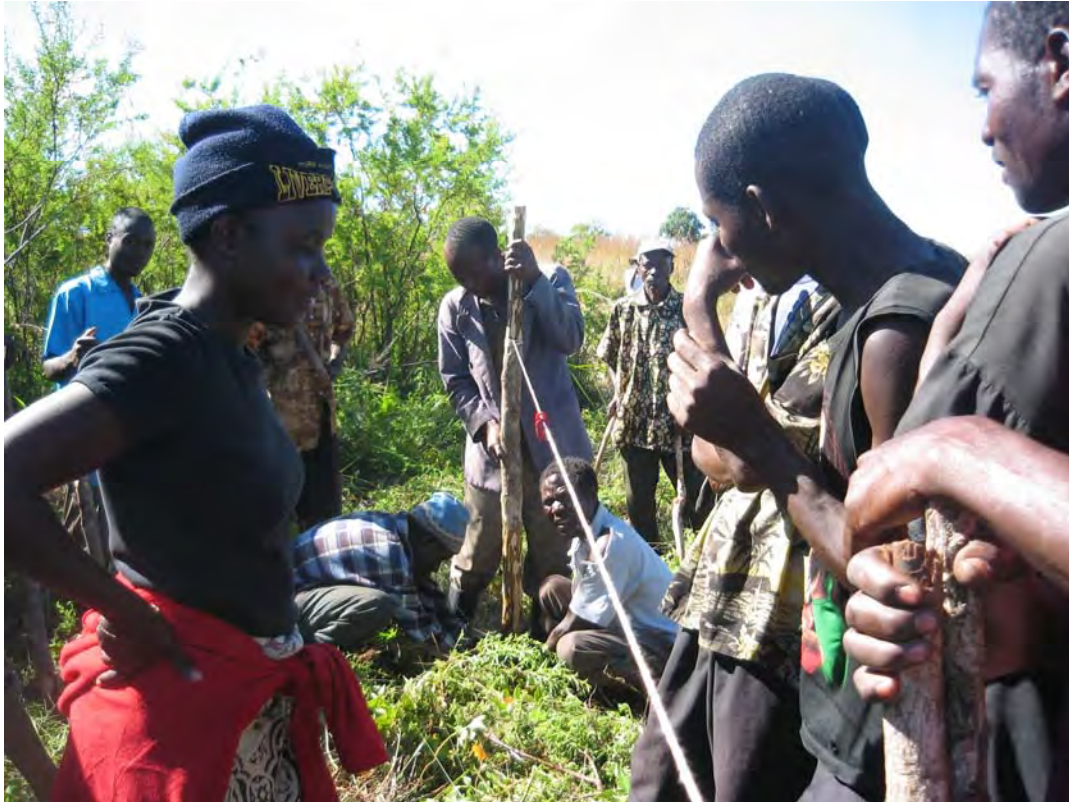
北部州 Munguwi 郡 Chibili サイトにおける用水路の道路横断工の建設状況である。横断工はモルタル練石積み造りで、幅約70cm、深さ50cm、道路横断幅はおよそ12mである。写真は横断工底部の工事を行っている状況で、周辺から採取した岩、石を水路底に敷き詰めたのち、モルタルを充填している。
