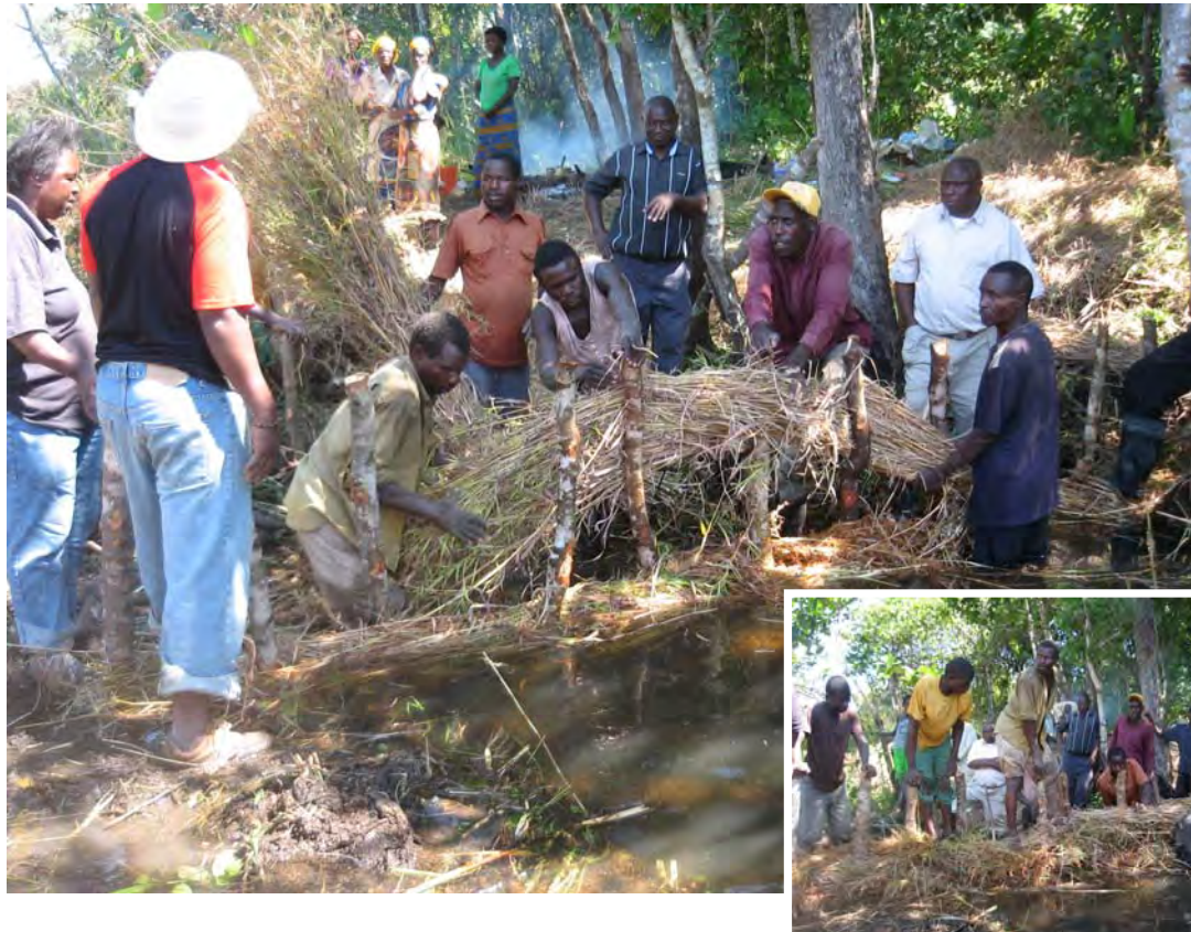
木杭間に編み込まれた草の層が積み上がっている。すでに貯水が開始されている様子がわかる。草を編み込む際には、足で締め固めながら積み上げることで空隙を密にし、堰を通過する漏水の軽減を図る（写真右下）。
