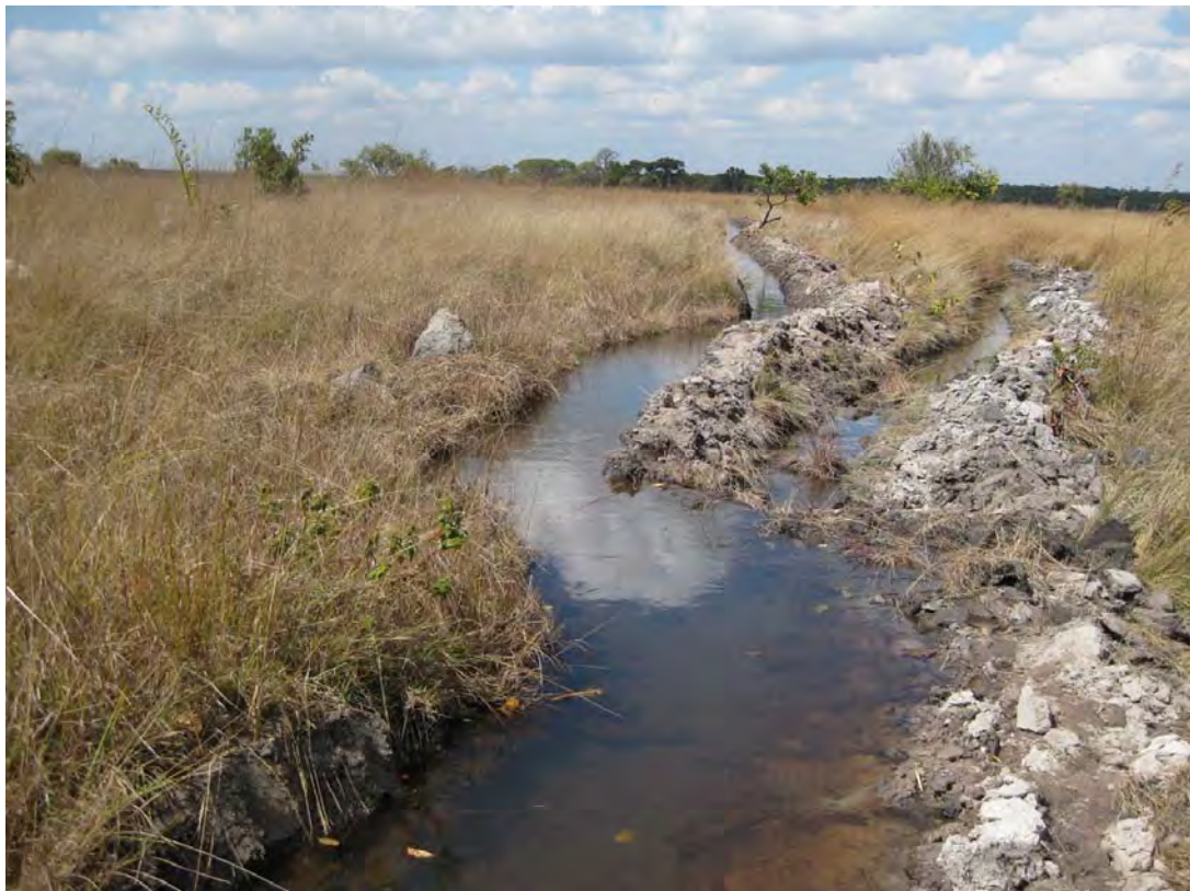
調査対象地域内には勾配の非常に緩やかな地形が多く存在する。そこでは、水路の線形に熟練が必要であるが、写真は水路線形をやり直した例である。また、地形が緩やかなために、水路が河川に平行して長く走ることとなり、灌漑面積がなかなか広がらない例も発生する。
