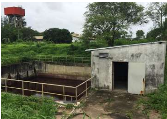
No.1 テキスタイル工場 (Shwedaung) 廃水貯水槽
