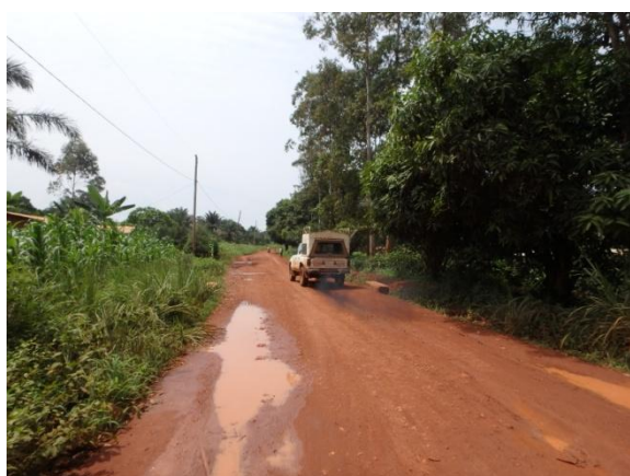
Détérioration de la route due au mauvais drainage à la saison des pluies (zone basse)
