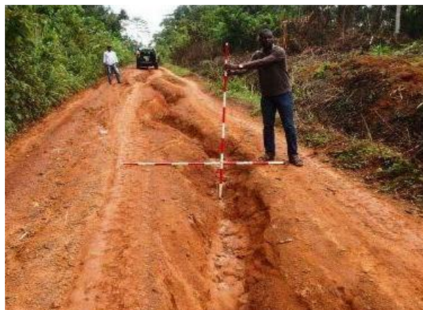
Ravinement des pentes
