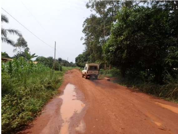
雨季の排水不良による路面の悪化（低地部）
