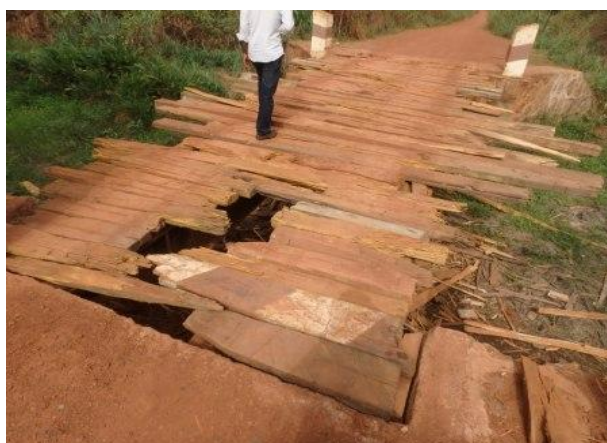
老朽化した橋梁
