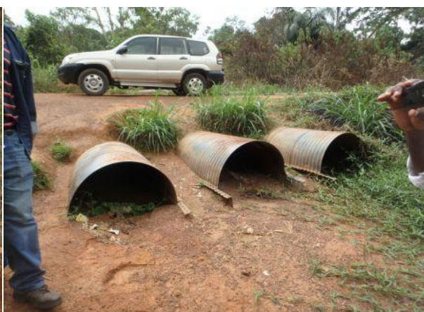
堆砂により通水断面が確保されていない管渠
