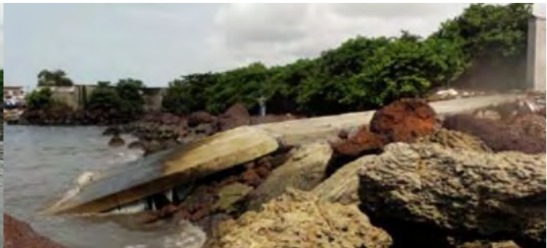
Slipway installé par l'ANPA pour les bateaux de surveillance de la pêche. L'inclinaison brutale de l'extrémité empêche de hisser ou de descendre les bateaux (30 novembre 2015)
