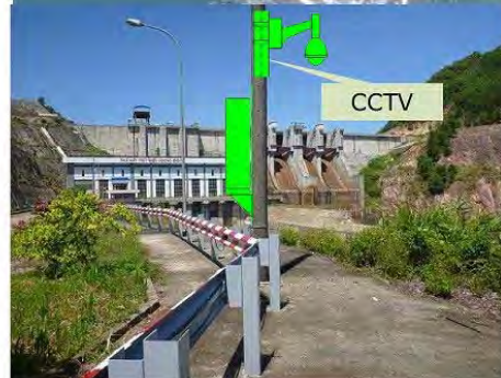
図 3-10 (8) CCTV カメラ (C8)
