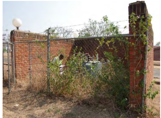
既存受変電設備 500KVA
