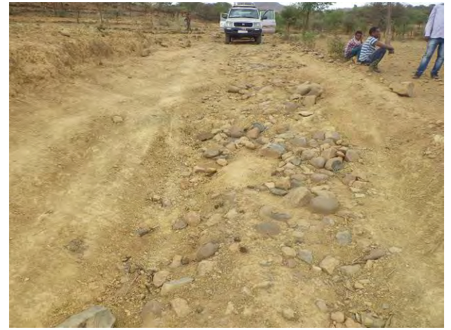
No. 5 アクセス道路は悪路となっており、補修の必要がある。
