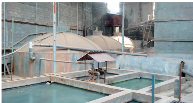
① 本事業の融資を利用した精米工場の廃水処理施設
