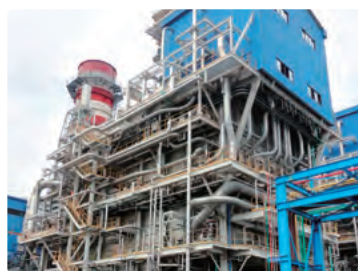
排熱回収ボイラー
