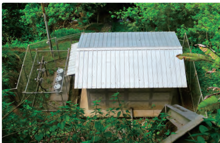
発電施設(セアシル)(写真手前から施設に入る管は水圧管)
