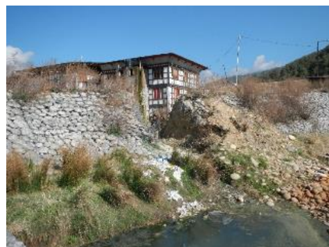
堤防に開けられた穴
