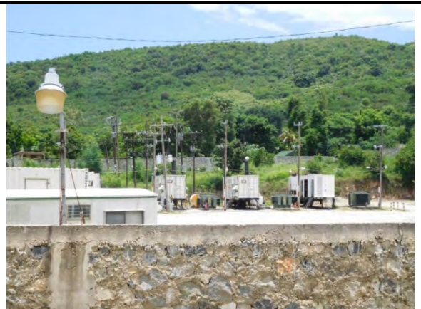
ハイトラック発電所 (プチゴアーブ市) 新設サイト付近を管轄する。電源車4台のみの小規模な発電所で、電力供給は不安定。 (2016年8月10日)
