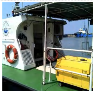
エアコン(ドア奥)と発電機
