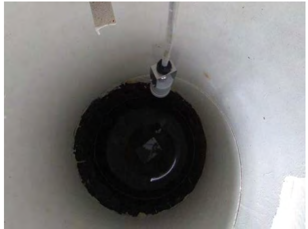
験潮井戸内部の潮位センサー ※観測時は水中
