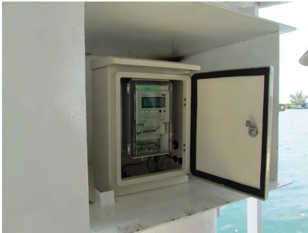
験潮小屋内部の RMD5225WLB-2 型験潮器
