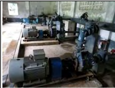
写真-68 配水ポンプ
