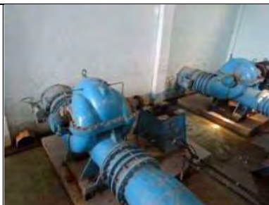
写真-3 取水ポンプ（電動機が故障して取り外されたまま放置）
