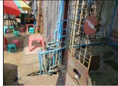
写真-82 各家庭への給水管
