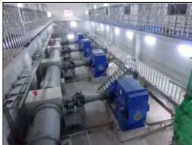
写真-30 フェーズ1新しい送水ポンプ場
