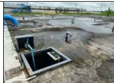
写真-32 フェーズ2の浄水池天井スラブの開口部
