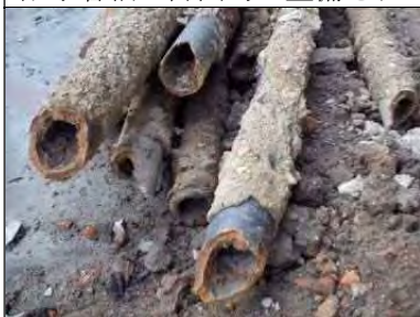
写真-61 老朽化した配水管
