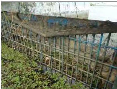
写真-2 草木が詰まった流入スクリーン（奥：沈砂池、手前：ポンプ井）
