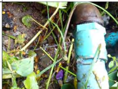
写真-65 給水装置漏水
