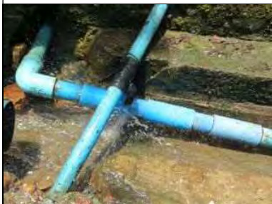
写真-64 給水管漏水
