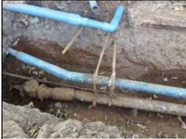
写真-80 昔の接続状況
