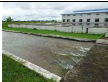
写真-31 フェーズ2浄水池からのオーバーフロー
