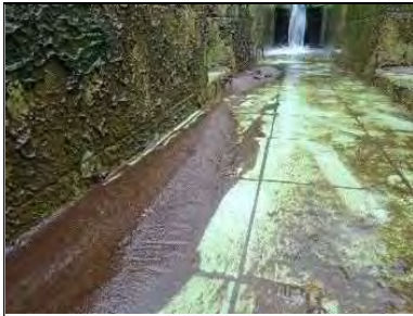
写真-16 ろ過池排水渠に流出したろ過砂
