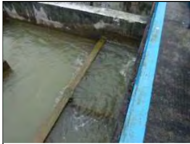
写真-13 フロック形成池の上下迂流壁の越流
