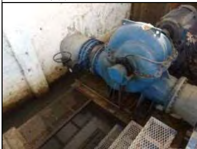
写真-5 グランドパッキン部の漏水
