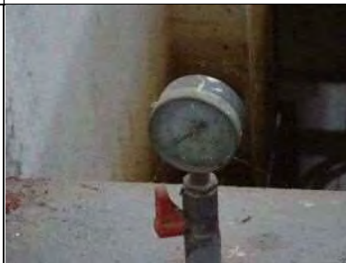
写真-6 取水ポンプ吐出管の圧力計
