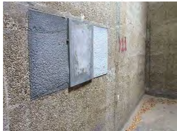
写真 7-4 SIKA 社による補修跡
