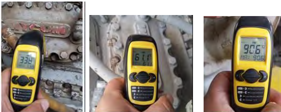
Torre de enfriamiento con falta de mantenimiento y presencia de sarro
