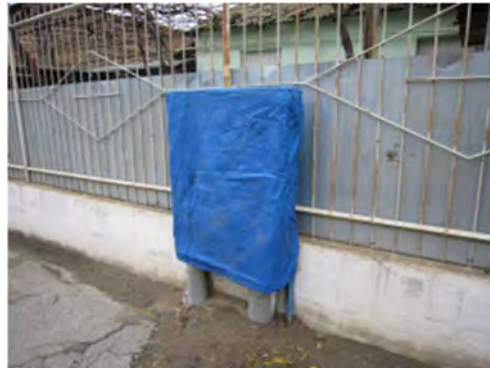
写真2 防寒マットを被せたメーターパネル
