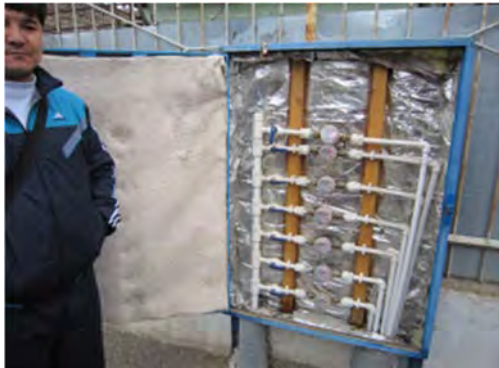
写真1 パネル内に設置されたメーター蓋の内側に断熱材が張られている。
