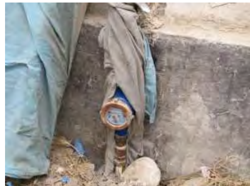
写真 2. レストランに設置されて いるメーター
