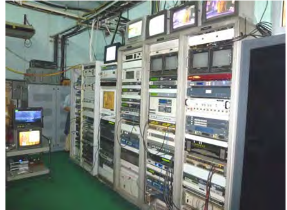
写真 8. 衛星送受信施設
