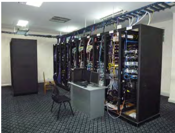
写真 17. コンテンツ機器室
