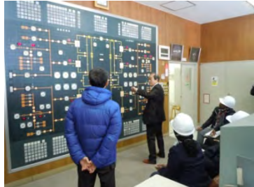
旧監視制御室
