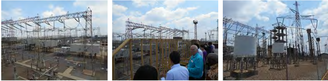
変換器と DC ヤード 屋上から説明を受ける 空芯リアクトル
