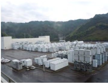
監視制御室からの風景
