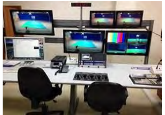
写真-14：2011 年に設置された MC の映像調整室。4 つのスタジオを切り替えて監視
