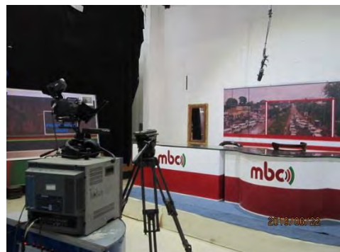
写真-6: 本計画対象機材が設置される予定のメインスタジオ(舞台下)(ニュース番組等)
