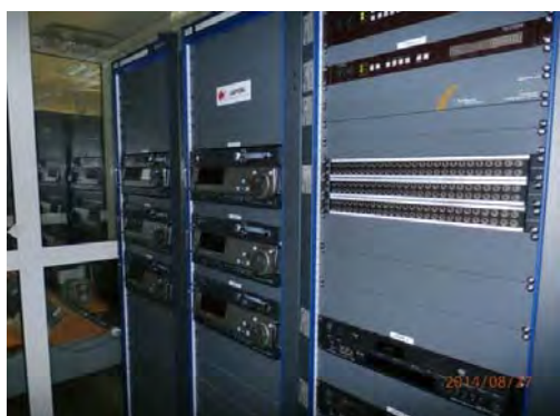
写真-7：ビデオサーバー用アップロード設備
