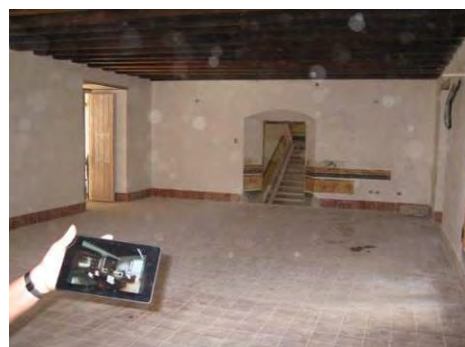
写真-6：中2階 図書室内装修復現況 天井・壁の電気配線は完了、壁は「キ」国側で塗装予定。
