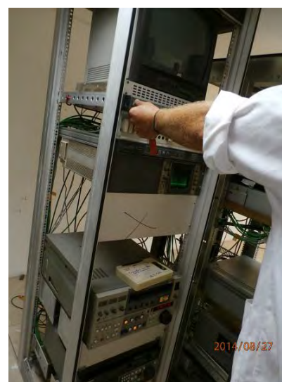
【写真3】 保守作業中のU-matic VTR
