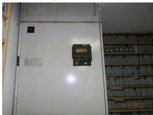
写真-3：テープ保管庫のエアコン設備
