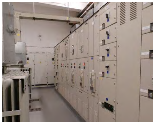
【写真4】電源設備
