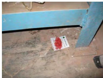
写真-6：収蔵庫防鼠薬配置状況 外注の業者が年に2度交換しているが効果は不明。
