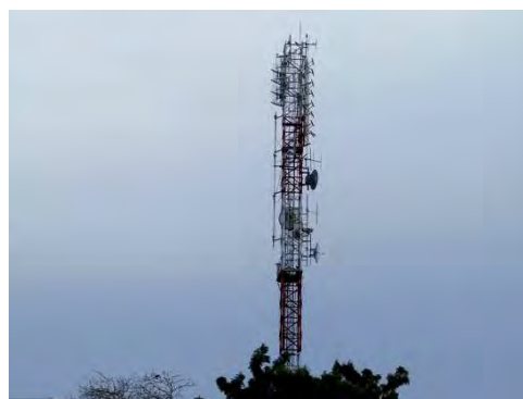
写真-8：RTD 敷地内の送信アンテナ アナログ/デジタル放送用アンテナ設備。
