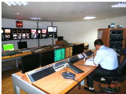
写真-5：第 1 チャンネル主調整室
