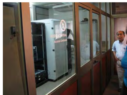
写真-8：OHCH 本部内サーバールーム 「文化会館」とネットワーク接続する。
